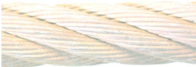
Рисунок Д.10 – Початок окиснення каната (сліди корозії). Корозію можна видалити протиранням. Ступінь ушкодження – 0%.
