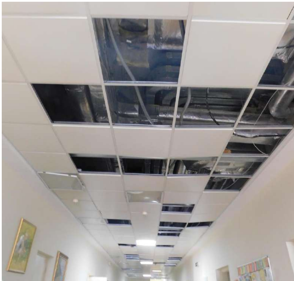
Рисунок 4.6 – Ділянка деформації/пошкодження системи кріплення підвісної стелі типу армстронг в осях Г-Д, 5-9 (приміщення №2)
