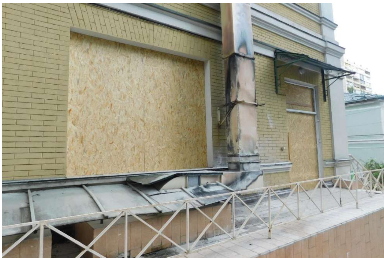
Рисунок 8.12 - Загальний вигляд фасаду в осях Е,1-3 з пошкодженими віконними заповненнями
