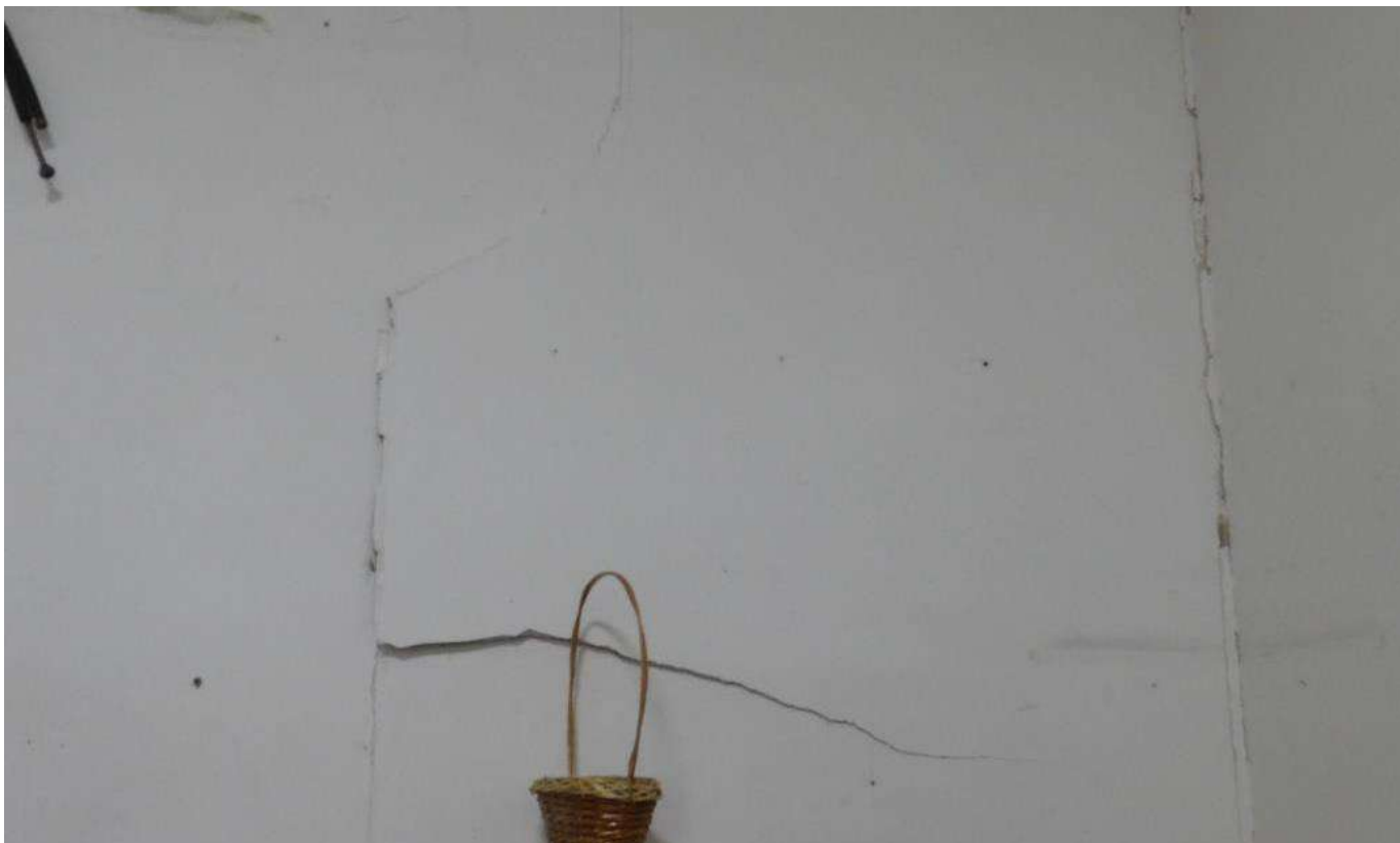
Рисунок 3.3 – Пошкоджена/деформована гіпсокартонна перегородка в осях 3, Д-Е (приміщення №18, №23)
