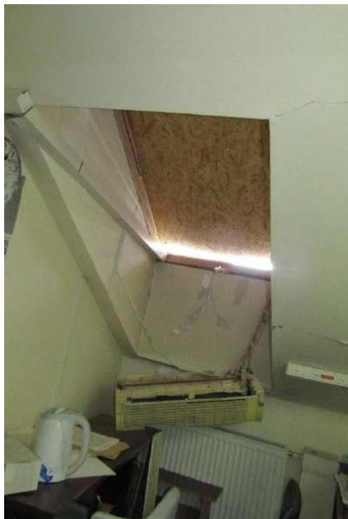
Рисунок 7.7 – Зруйноване/відсутнє віконне заповнення, в осях Б-Д, 1-3 (приміщення №3)
