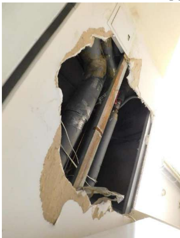
Рисунок 2.12 - Пошкоджено гіпсокартоне опорядження стіни приміщення 81 в осях В/Г-Г,13-14
