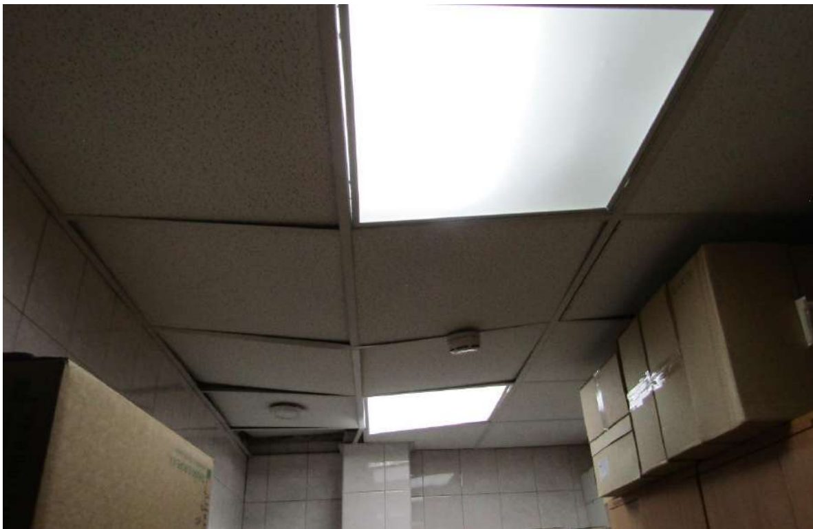
Рисунок 6.8 – Ділянка пошкодження підвісної системи типу армстронг в осях Б-В/Г, 2-3 (приміщення №39)
