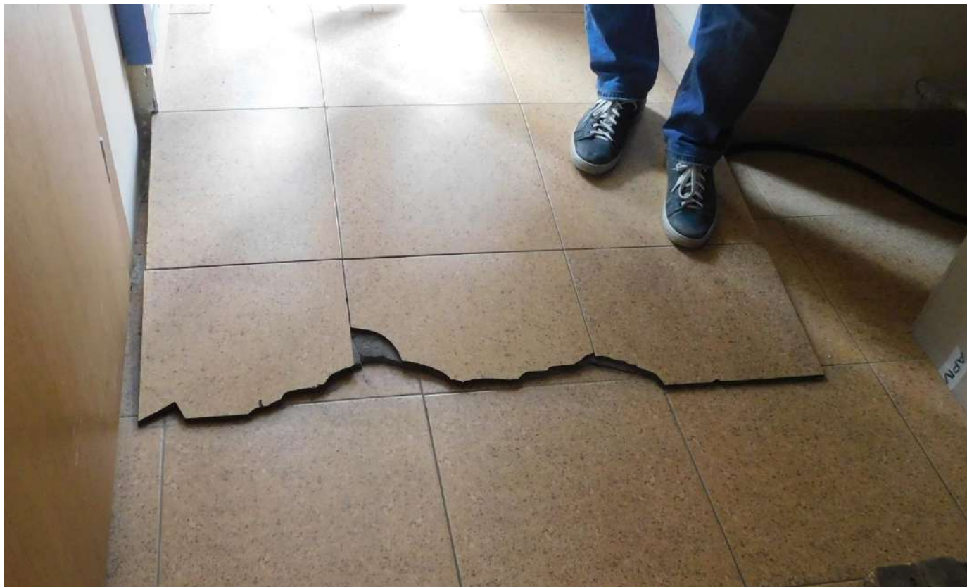
Рисунок 3.26 – Пошкоджений поріг з керамічної плитки в осях Д-Е, 11-12 (приміщення №40)
