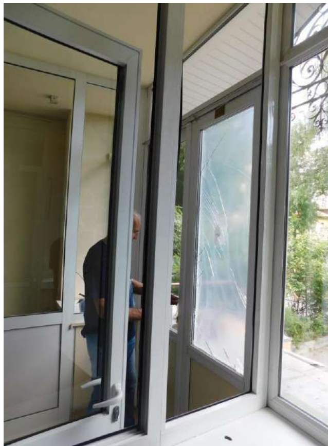
Рисунок 3.15 - Відсутні віконні заповнення металопластикової перегородки в осях А-Б, 6-7 (приміщення №1)
