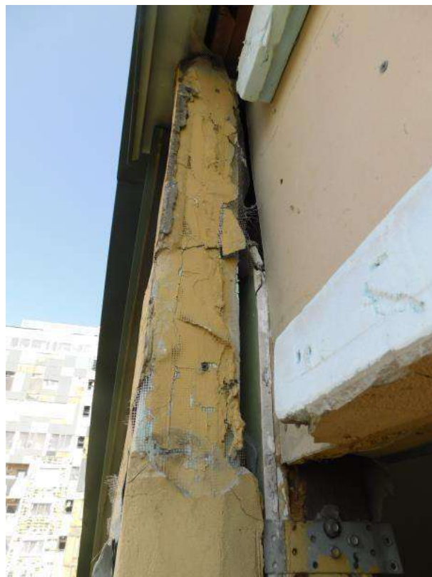
Рисунок 8.24 – Пошкодження та деформація опорядження стіни в місці розташування технічного отвору для доступу на покрівлю зі сторони бокового фасаду в осях 1, Е-А
