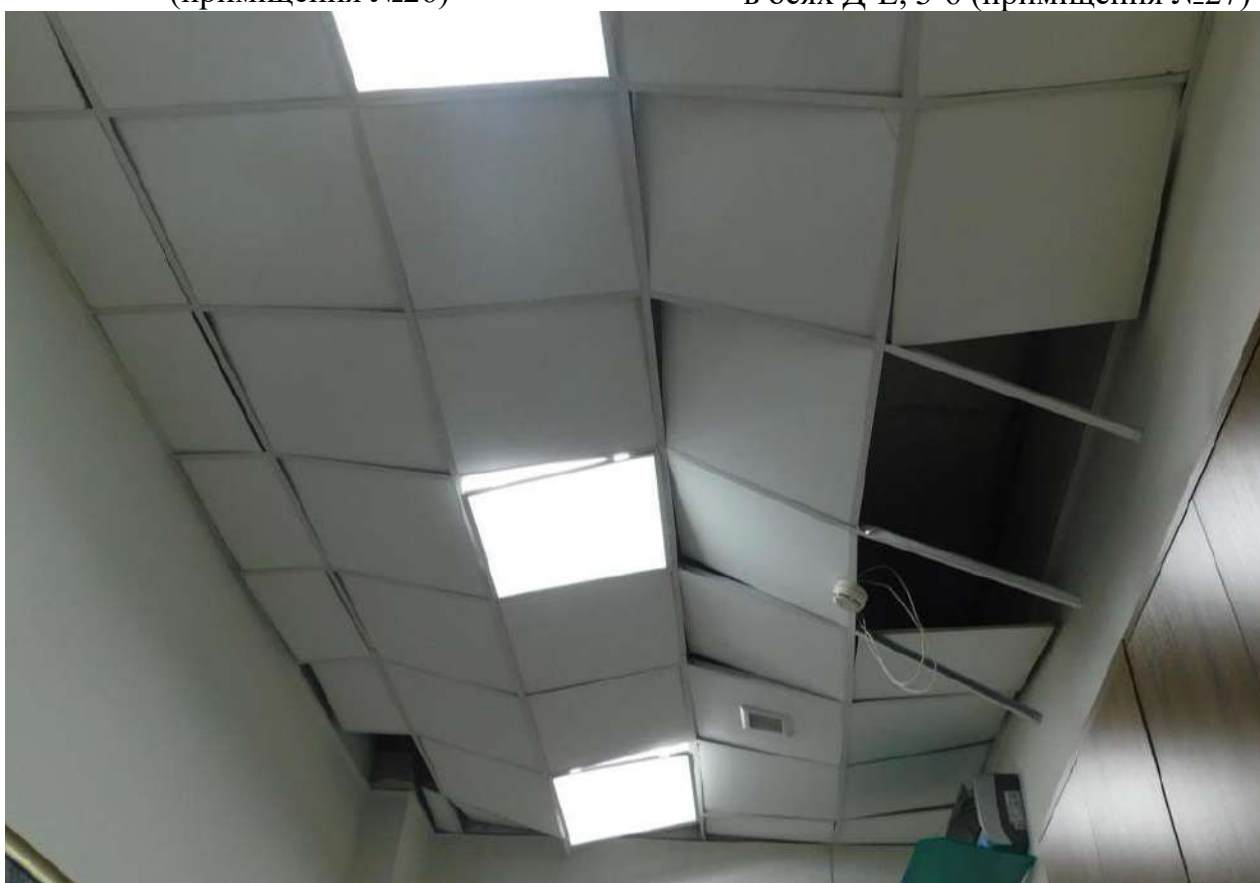
Рисунок 3.9 – Ділянка руйнування/пошкодження системи кріплення підвісної стелі типу армстронг в осях Д-Е, 6-7 (приміщення №31)
