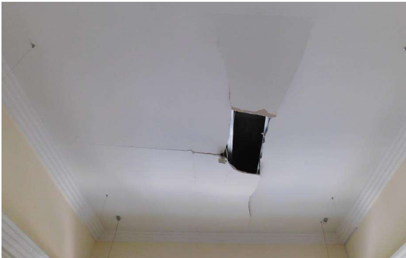
Рисунок 3.12 – Пошкодження опорядження стелі (гіпсокартону) в осях Б-Г, 6-7 (приміщення №2)
