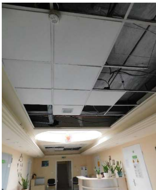
Рисунок 2.5 - Пошкодження підвісної стелі системи «Армстронг» приміщення 59 в осях Г-Д, 14-15
