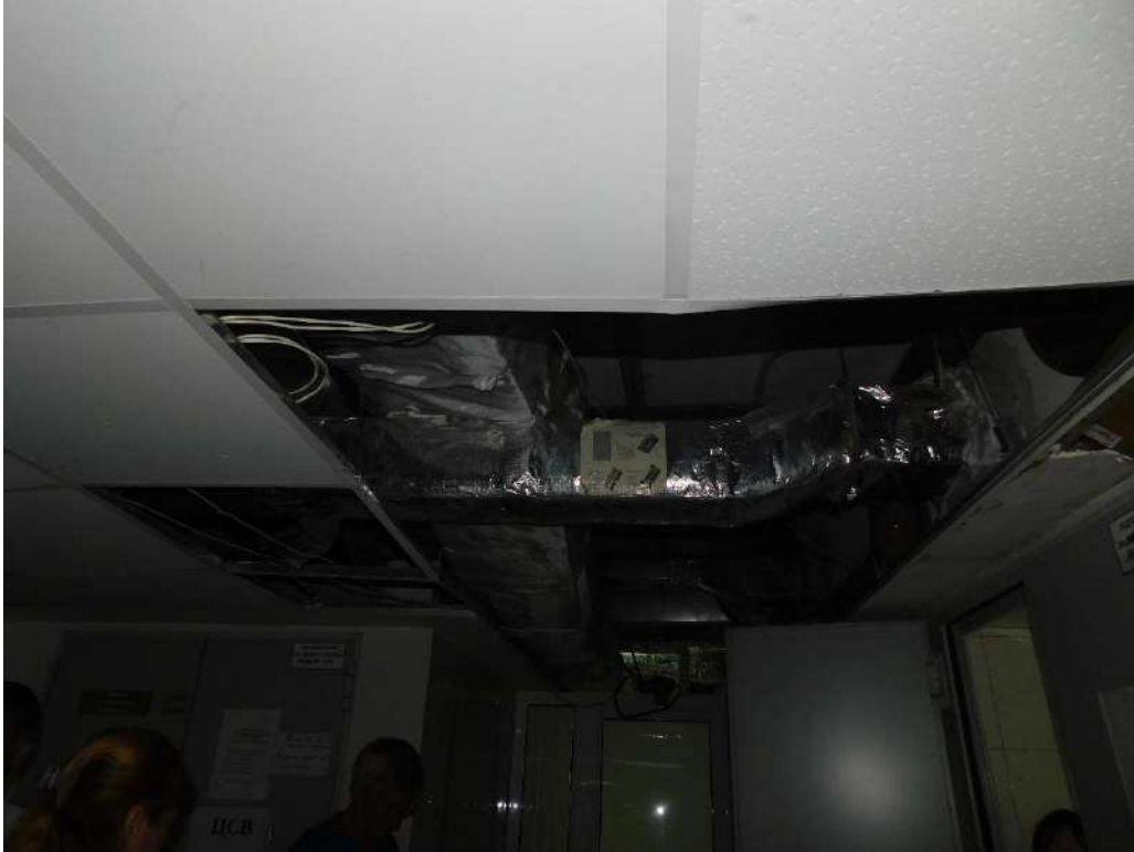
Рисунок 2.2 - Пошкодження підвісної стелі системи «Армстронг» приміщення 59 в осях Г-Д,16-17
