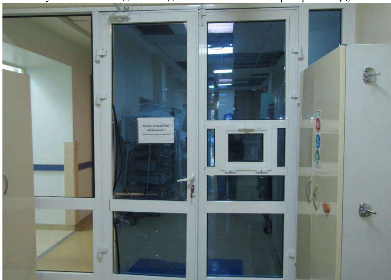
Рисунок 5.6 - Пошкодження склоблоків металопластикової перегородки Г-Д, 4-5
