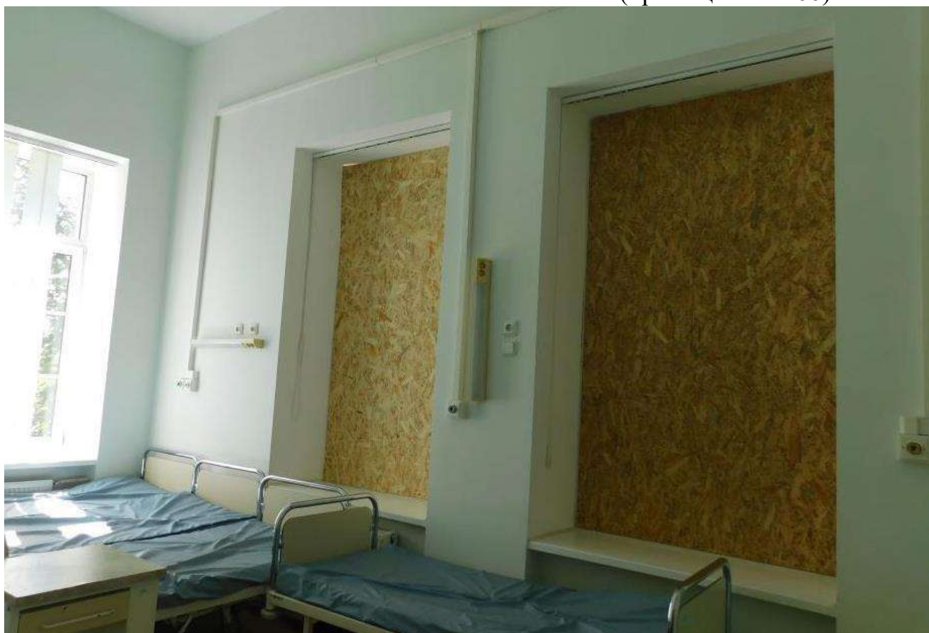
Рисунок 4.16 – Пошкоджені віконні рами та заповнення(скління) в осях 1, А-Б (приміщення №61)
