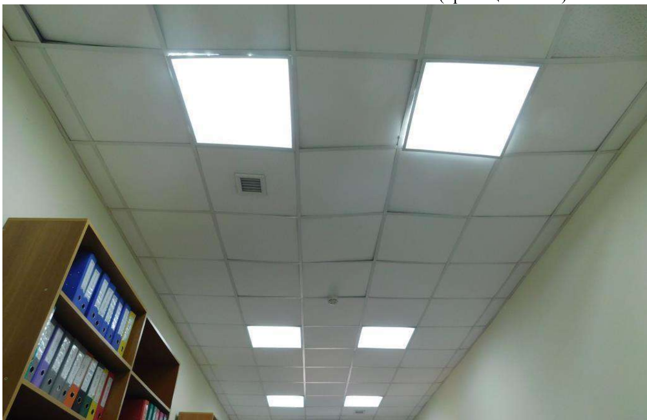
Рисунок 3.16 – Деформована підвісна система типу армстронг в осях Б-Г, 5-8 (приміщення №4)
