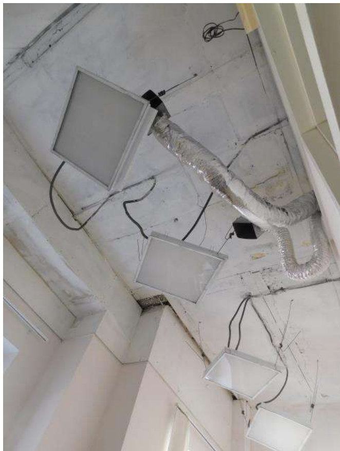
Рисунок 4.24 - Ділянка руйнування системи кріплення підвісної стелі типу армстронг в осях Д-Е, 7'-9 (приміщення №20)
