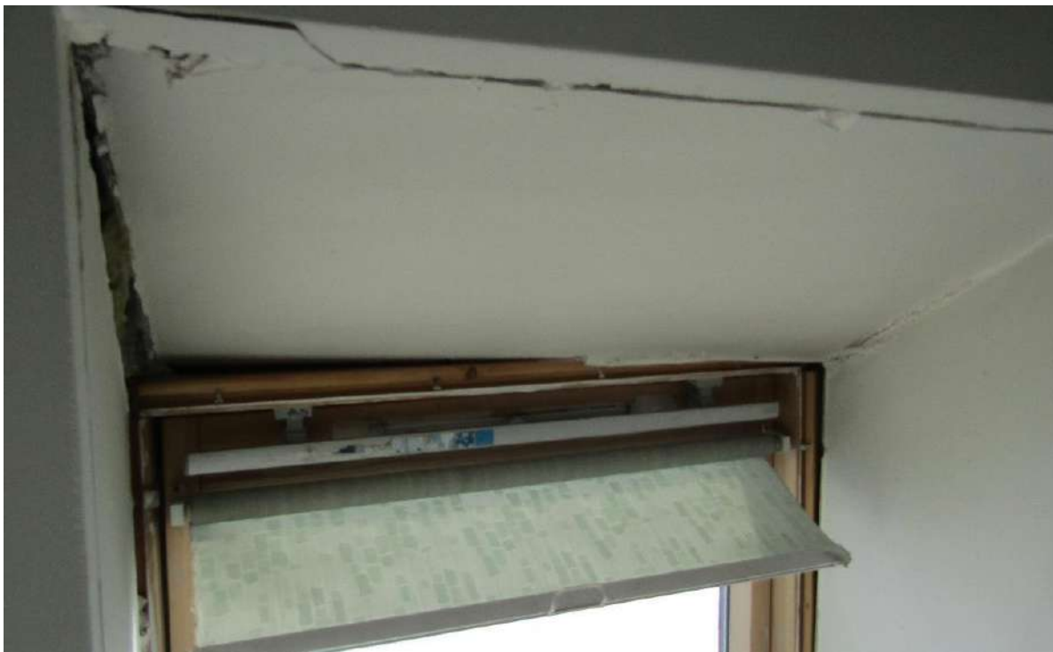
Рисунок 7.14 – Пошкодження віконного заповнення. Утворення тріщини по гіпсокартонному опорядженню стелі в осях Б-Г, 4-5 (приміщення №22)
