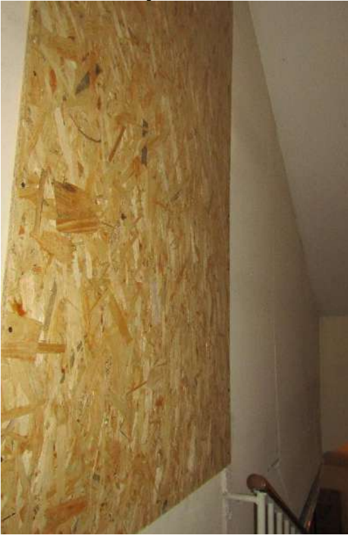
Рисунок 7.1 – Зруйноване/відсутнє віконне заповнення в осях Д-Е, 1-2 (приміщення №1)
