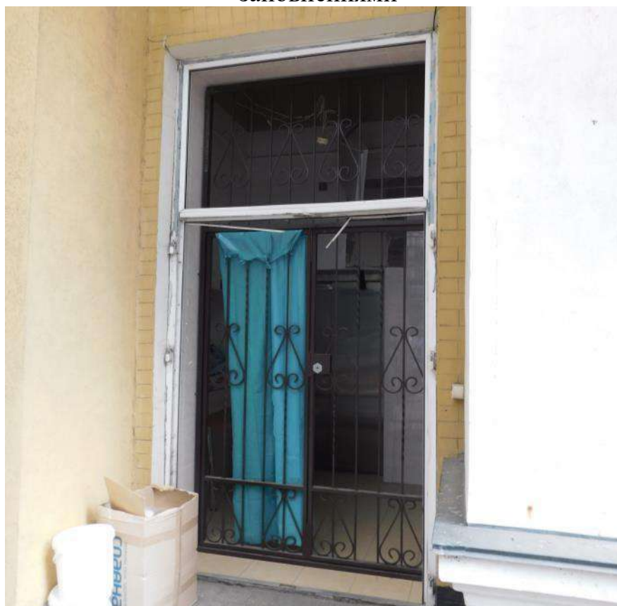
Рисунок 8.10 - Пошкоджене дврне заповнення в осях Е,7-6
