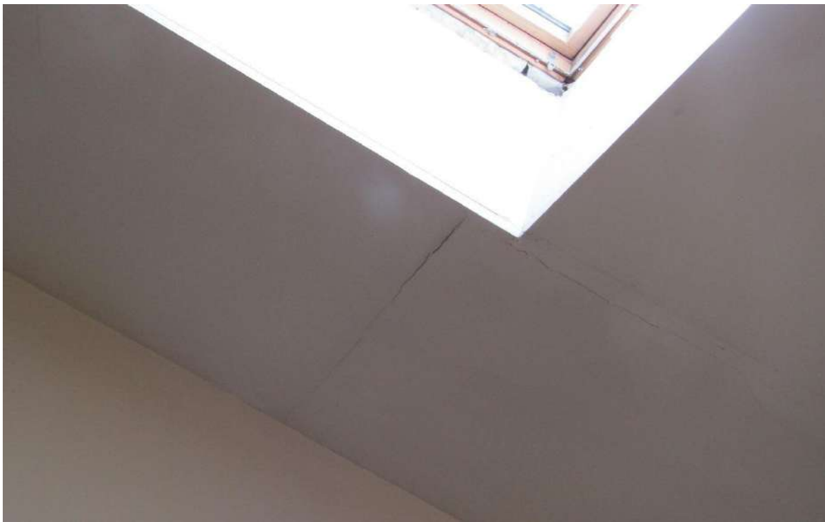
Рисунок 7.20 Утворення тріщин по гіпсокартонному опорядженню стелі в осях Д-Е, 11-12 (приміщення №18)
