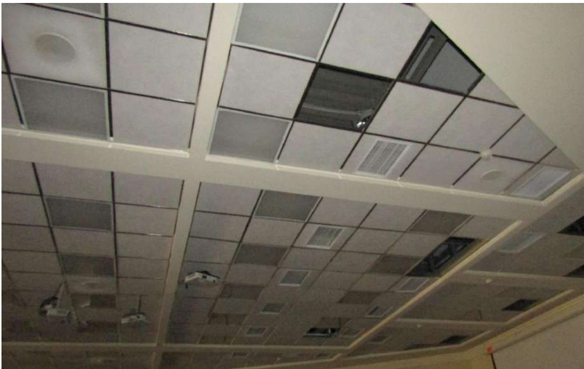
Рисунок 6.6 – Зруйнована/пошкоджена підвісна система типу армстронг в осях Б-Е, 5-8 (приміщення №10)
