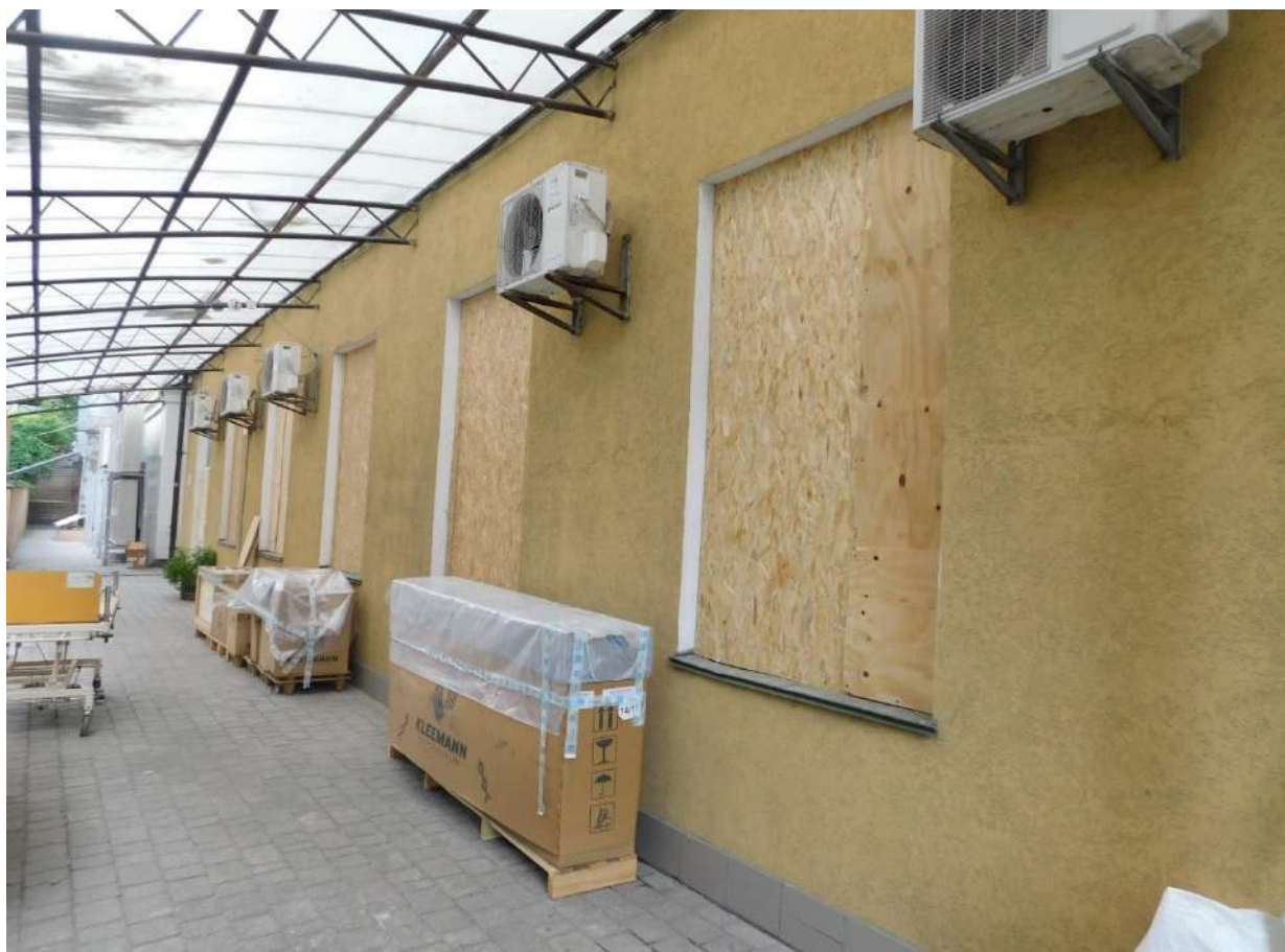
Рисунок 8.11 - Загальний вигляд фасаду в осях Е,3-13 з пошкодженими віконними заповненнями
