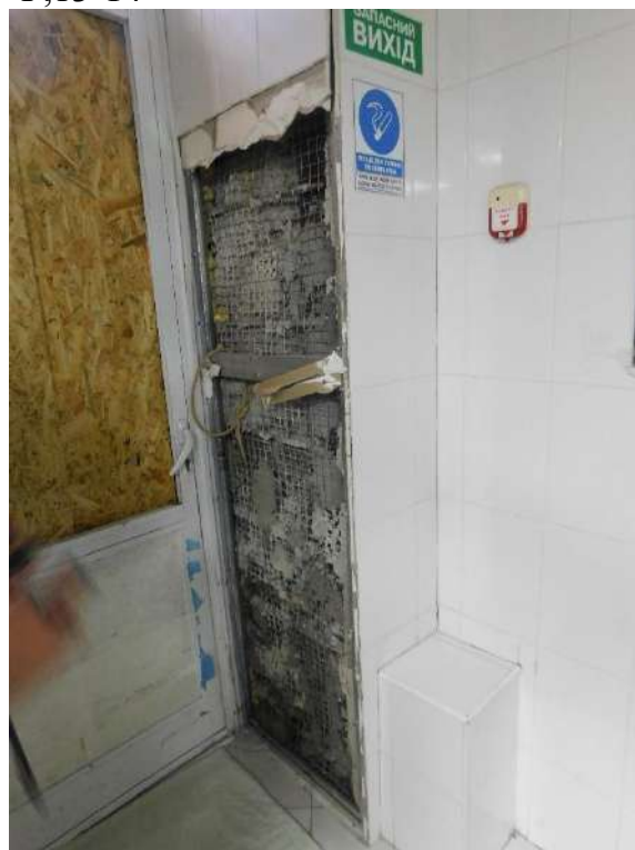
Рисунок 2.13 - Пошкодження керамічної плитки та гіпсокартонного опорядження стіни, пошкодження склоблоку металопластикової двері приміщення 1 в осях Г-Д,1-2
