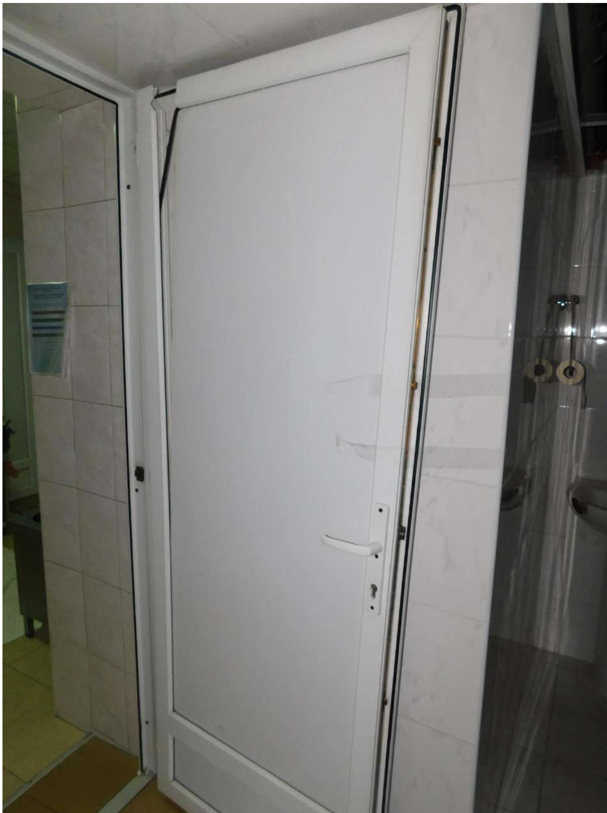
Рисунок 2.14 Пошкодження каркасу металопластикових дверей приміщення 32 в осях Г-Д,1-4
