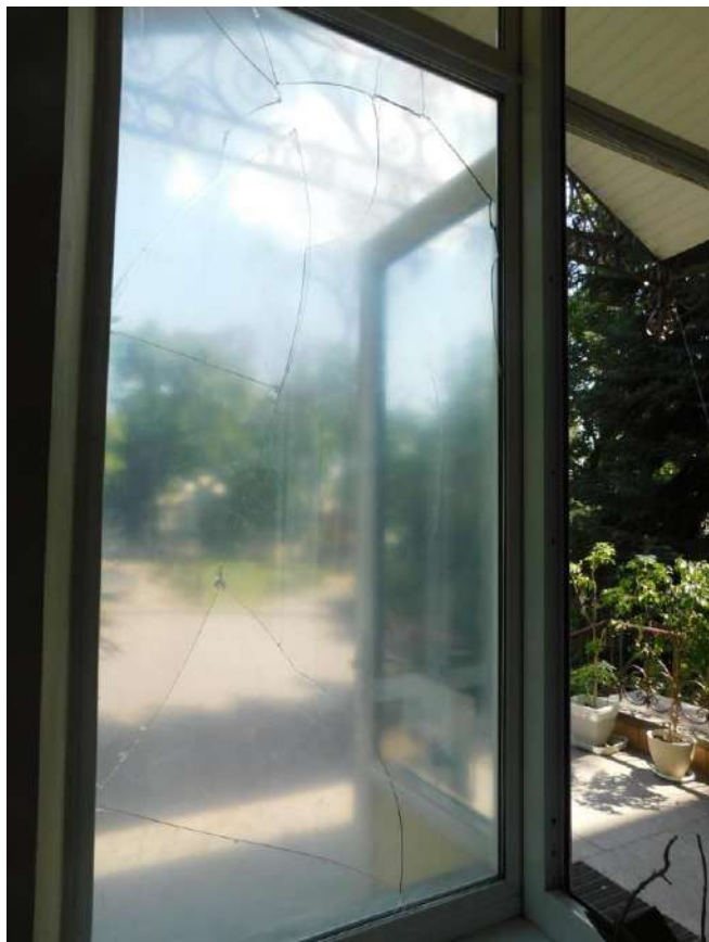
Рисунок 3.14 – Пошкоджене віконне заповнення (скління) в осях А-Б, 6-7 (приміщення №2)
