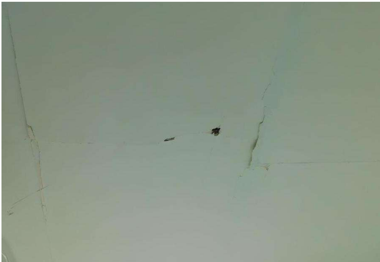
Рисунок 4.17 – Вертикальні та горизонтальні наскрізні тріщини по гіпсокартонній перегородці в осях 2, А-Б (приміщення №60, 61)
