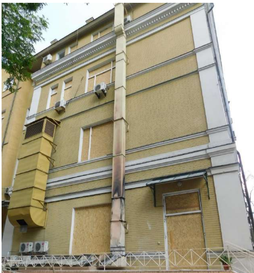
Рисунок 8.5 - Загальний вигляд фасаду в осях Е,1-2 з пошкодженими віконними заповненнями
