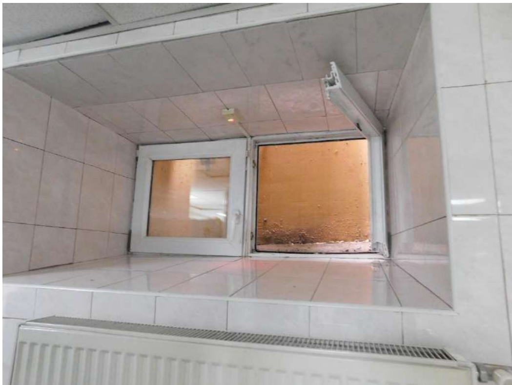
Рисунок 2.9 - Пошкодження металопластикового профілю віконного заповнення приміщення 2 в осях Е ,2-3
