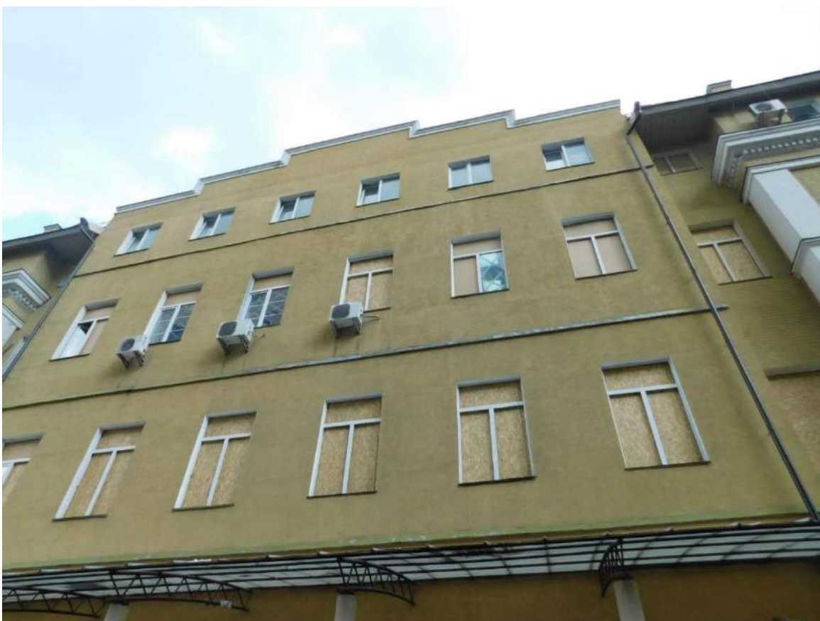
Рисунок 8.9 - Загальний вигляд фасаду в осях Е,11-6 з пошкодженими віконними заповненнями
