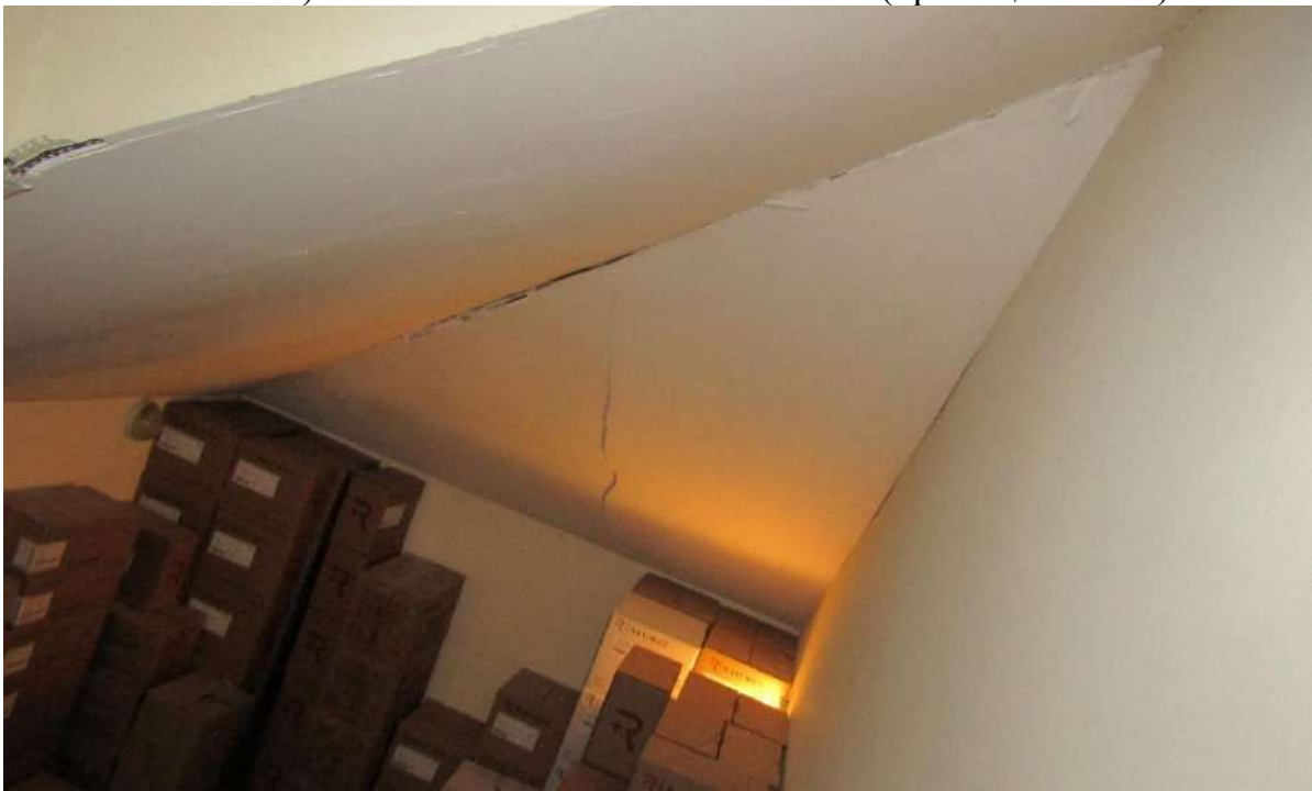
Рисунок 7.3 – Утворення тріщин по гіпсокартонному опорядженню стелі в осях Д-Е, 1-2 (приміщення №1)
