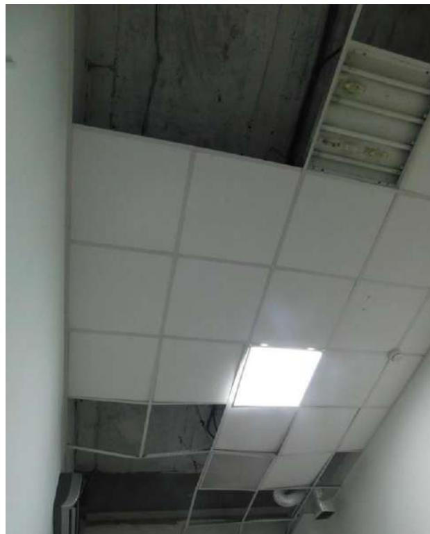
Рисунок 3.8 – Ділянка руйнування/пошкодження системи кріплення підвісної стелі типу армстронг в осях Д-Е, 5-6 (приміщення №27)
