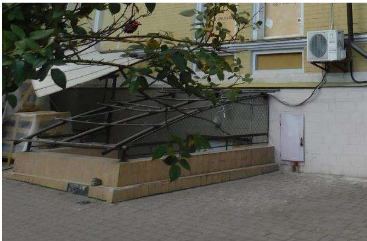
Рисунок 8.13 – Пошкодження накриття прямку в осях 1, Е-Г
