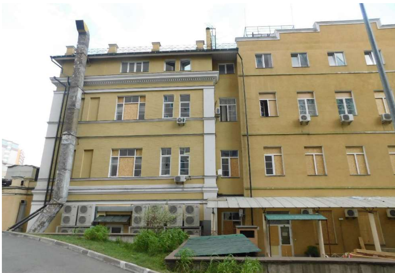
Рисунок 8.6 - Загальний вигляд фасаду в осях Е,13-8 з пошкодженими віконними заповненнями
