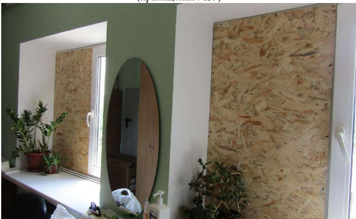
Рисунок 6.9 – Зруйновані/відсутні віконні заповнення в осях Б-Г, 1 (приміщення №40)
