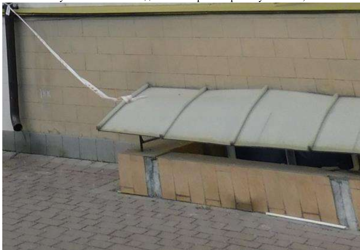
Рисунок 8.14 – Деформоване накриття прямку в осях 1,Б/1-А
