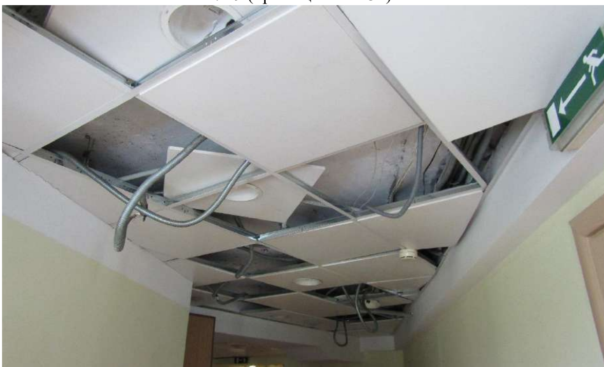
Рисунок 6.5 – Деформована підвісна система типу армстронг в осях Б-Г, 5-6 (приміщення №34)
