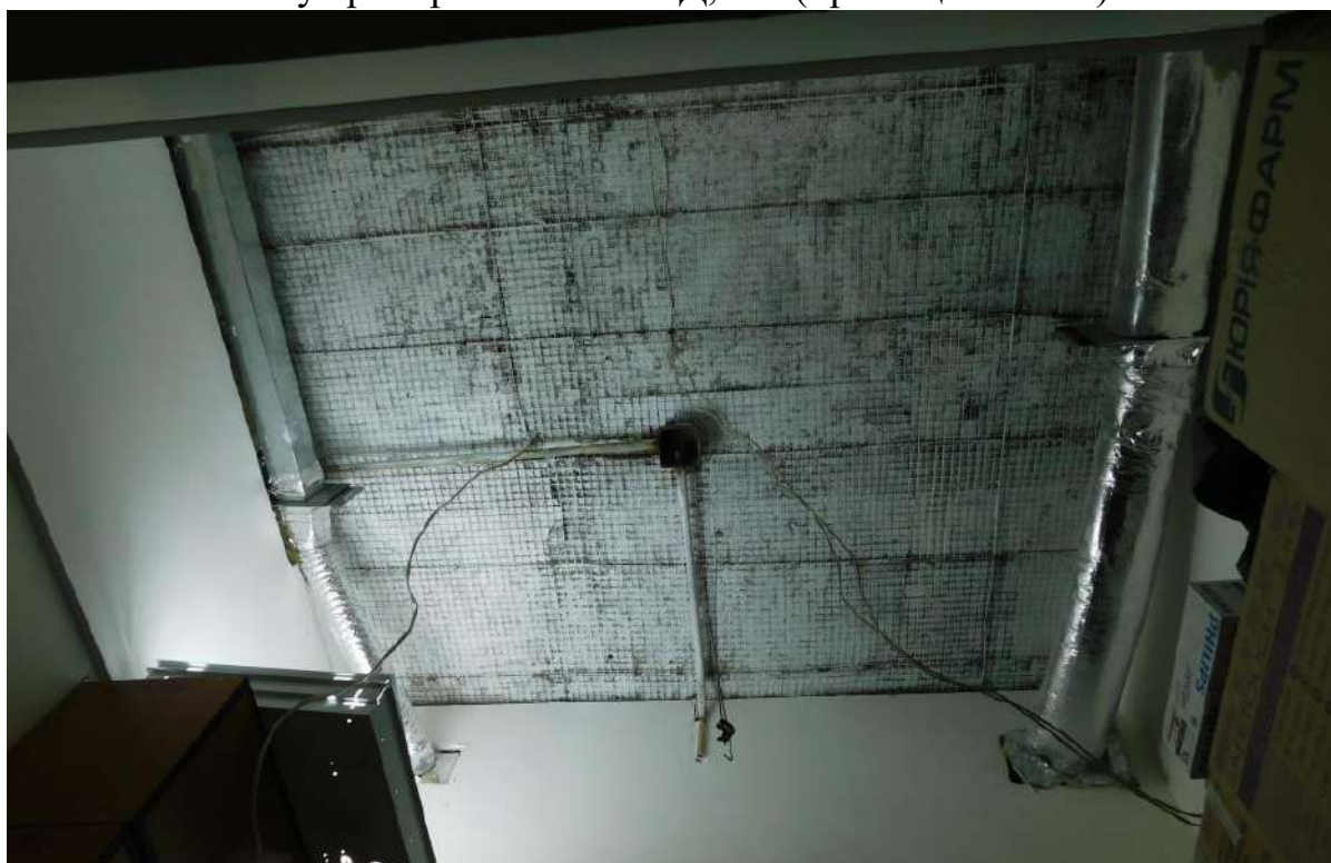
Рисунок 4.7 - Ділянка руйнування системи кріплення підвісної стелі типу армстронг в осях В/Г-Г, 7'-8 (приміщення №45)
