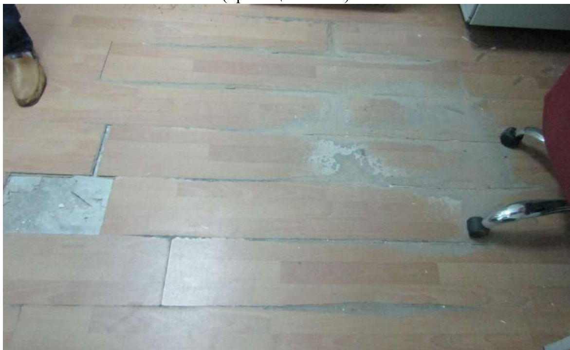
Рисунок 7.5 – Ділянка пошкодження опорядження підлоги (ламініат) в осях Д-Е, 2-3 (приміщення №5)
