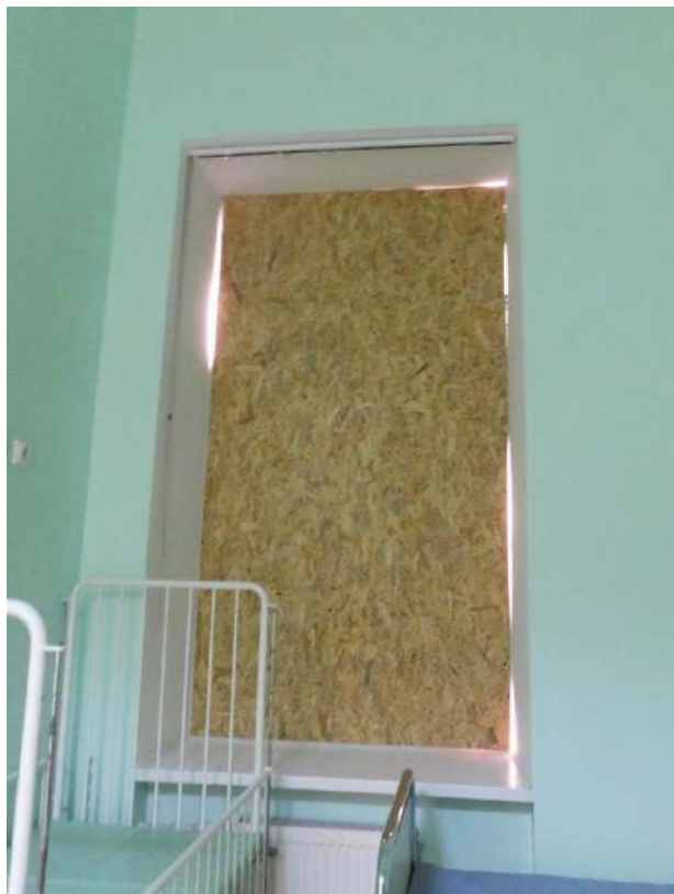
Рисунок 4.14 – Пошкоджене вікно з заповнення (скління) та рама в осях 1, В/Г-Г (приміщення №66)
