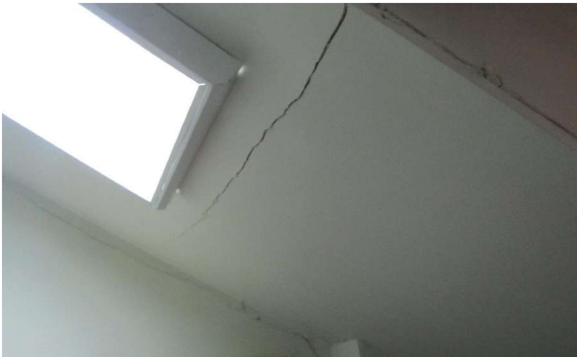
Рисунок 7.4 – Утворення тріщин по гіпсокартонному опорядженню стелі в осях Д-Е, 2-3 (приміщення №5)
