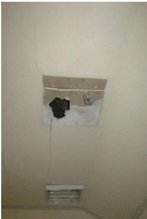
Рисунок 7.6 – Тріщина по гіпсокартонному опорядженню стелі в осях Г-Д, 2-3 (приміщення №3)
