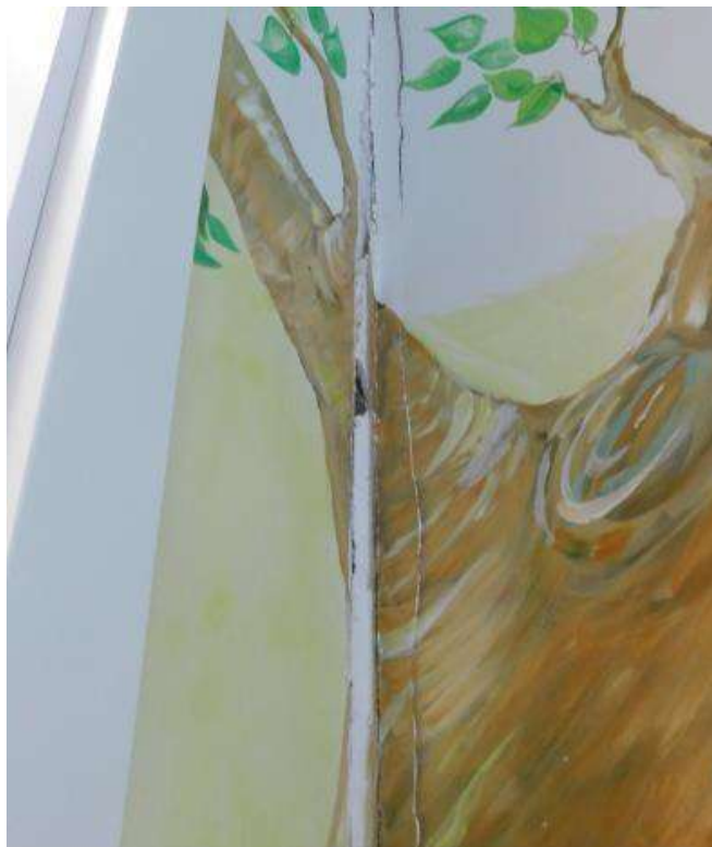
Рисунок 4.20 – Вертикальна тріщина по стику суміжних конструкцій стін на всю висоту поверху в осях Д-Е, 2-3 (приміщення №4)
