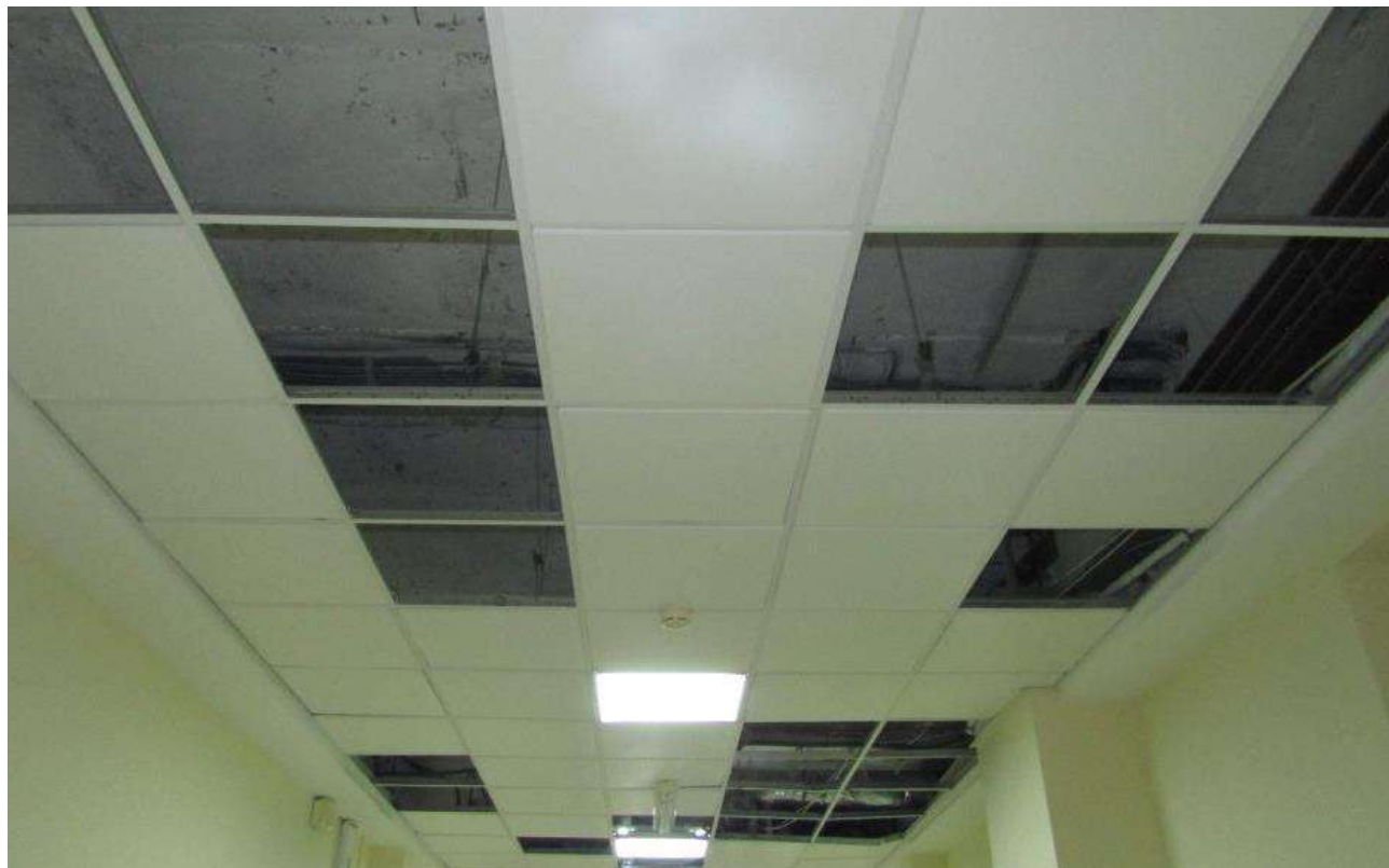
Рисунок 5.5 - Пошкодження підвісної стелі системи «Армстронг» Г-Д, 1-4
