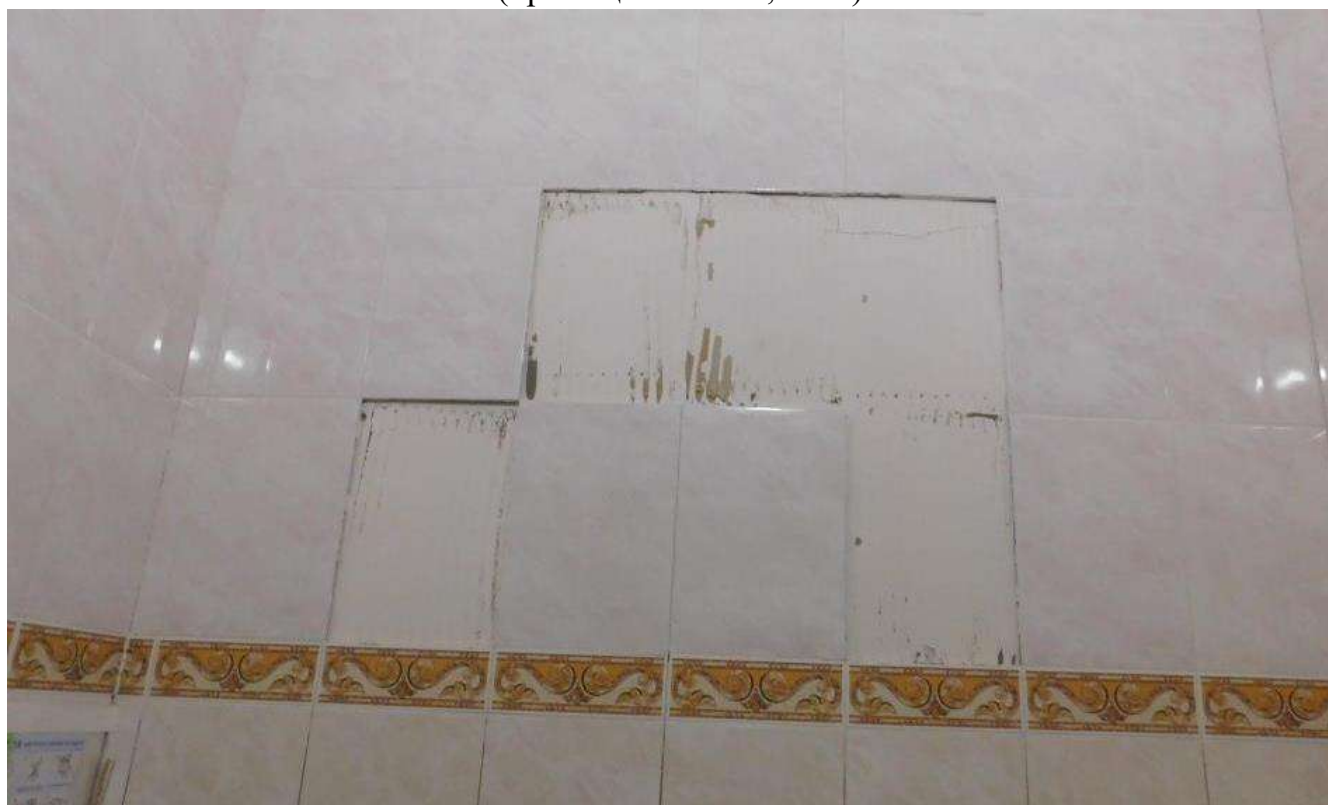
Рисунок 3.4 – Ділянка відпадиння керамічної плитки по стіні в осях Д-Е, 2-3 (приміщення №20)
