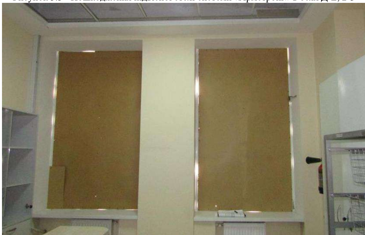
Рисунок 5.4 - Руйнування віконного заповнення в осях 1, Г-Д
