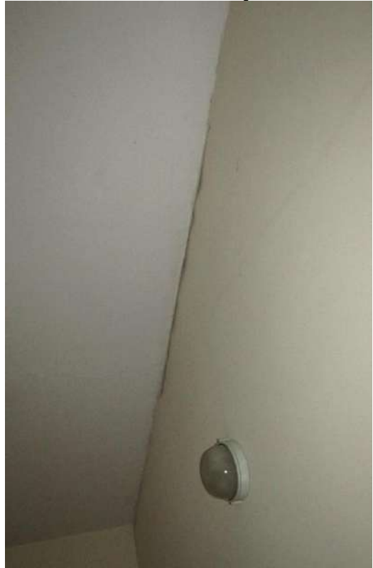
Рисунок 7.2 – Утворення тріщини по опорядженню вздовж стиків в осях Д-Е, 2 (приміщення №1)
