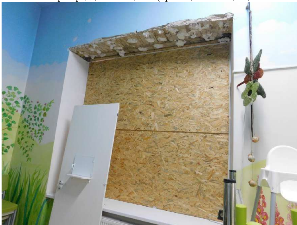
Рисунок 4.18 – Пошкоджений віконний блок (заповнення, рама) в осях Е, 2-3 (приміщення №4)
