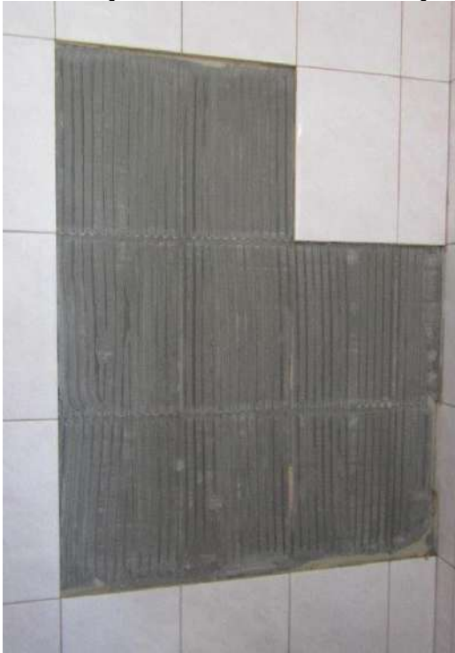
Рисунок 6.1 – Ділянка відпадиння керамічної плитки по перегородці в осях Д-Е, 9-10 (приміщення №26)
