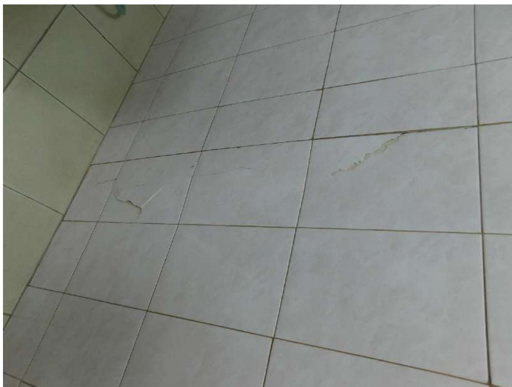
Рисунок 2.10 - Тріщини керамічної плитки опорядженні стіни приміщення 3 в осях Д-Е,2
