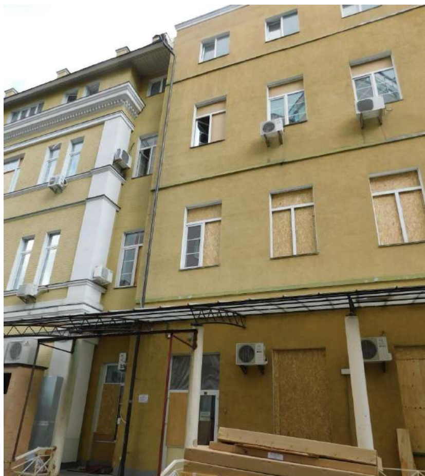
Рисунок 8.8 - Загальний вигляд фасаду в осях Е,12-7 з пошкодженими віконними заповненнями
