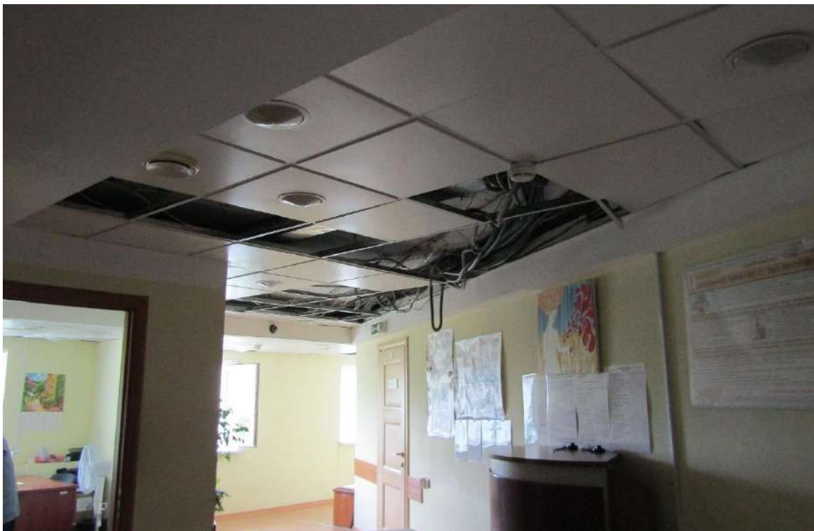
Рисунок 6.4 – Деформована/пошкоджена підвісна система типу армстронг в осях Б-Г, 7'-9 (приміщення №34)
