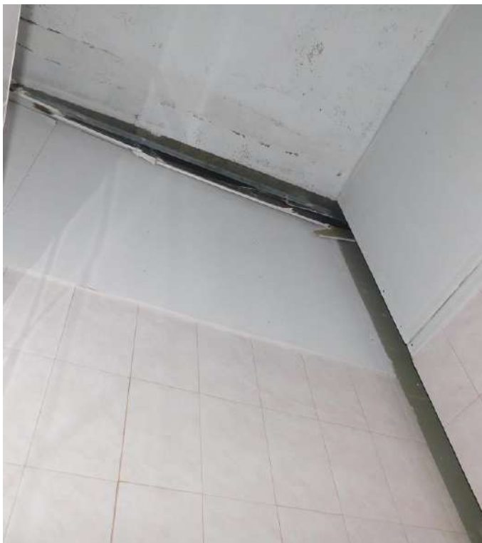
Рисунок 3.23 – Деформована міжкімнатна гіпсокартонна перегородка в осях Б/1-В/Г, 1-3 (приміщення №14)
