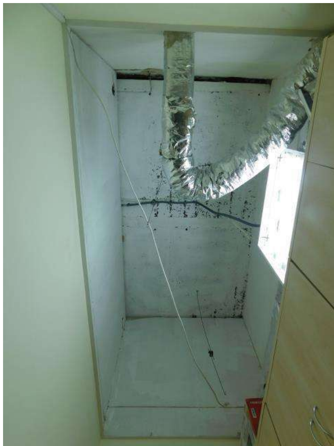
Рисунок 4.25 - Ділянка руйнування системи кріплення підвісної стелі типу армстронг в осях Д-Е, 9-11 (приміщення №23)
