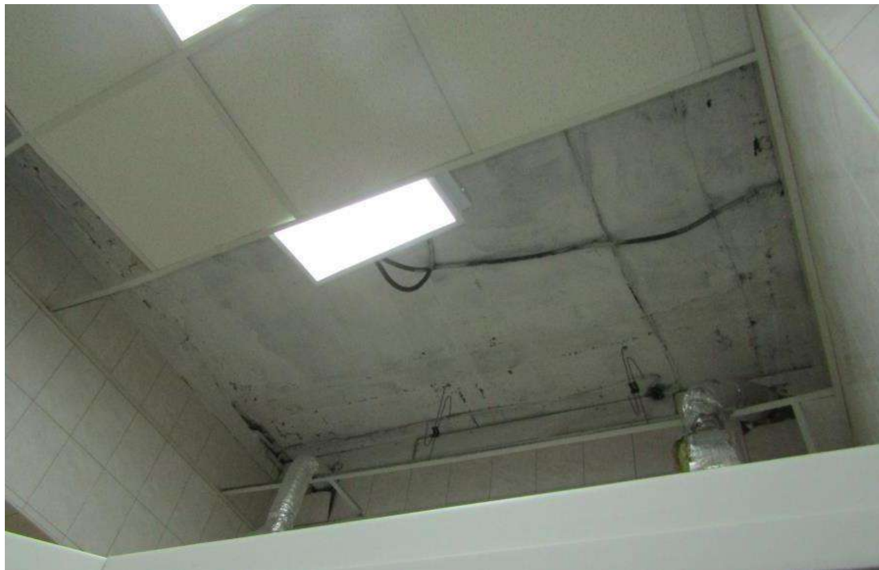
Рисунок 5.3 - Пошкодження підвісної стелі системи «Армстронг» в осях Д-Е, 2-3
