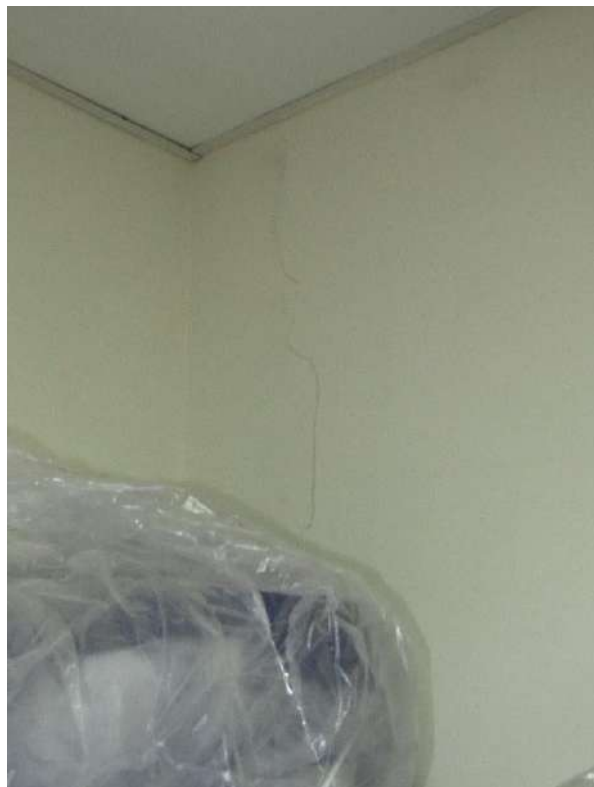
Рисунок 6.11 – Вертикальна тріщина по опорядженню стіни в осях В/Г-Г, 2-3 (приміщення №36)
