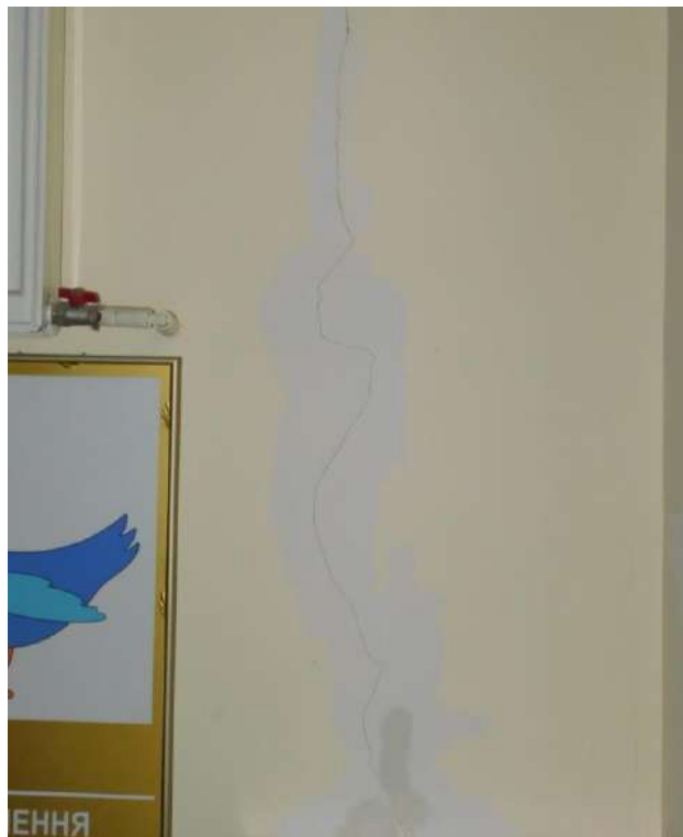
Рисунок 3.24 – Вертикальні тріщини по опорядженню стіни в осях Д, 1-2 (приміщення №17)
