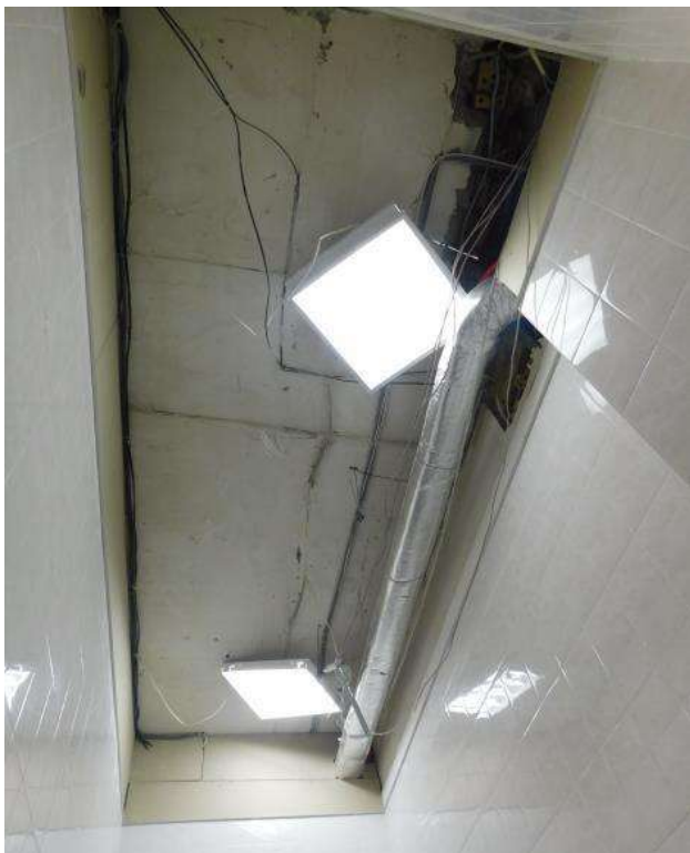
Рисунок 3.7 – Ділянка руйнування/пошкодження системи кріплення підвісної стелі типу армстронг в осях Д-Е, 5-6 (приміщення №26)
