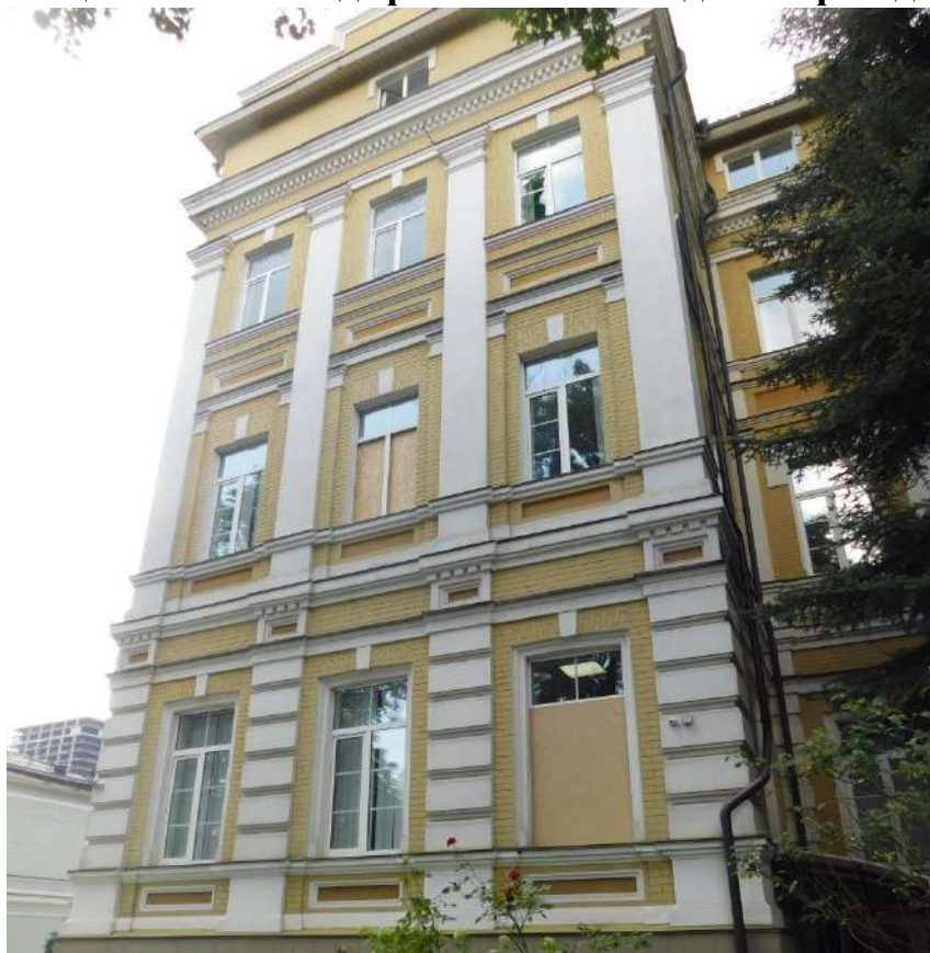
Рисунок 8.3-Загальний вигляд фасаду в осях А,1-3 з пошкодженими віконними заповненнями
