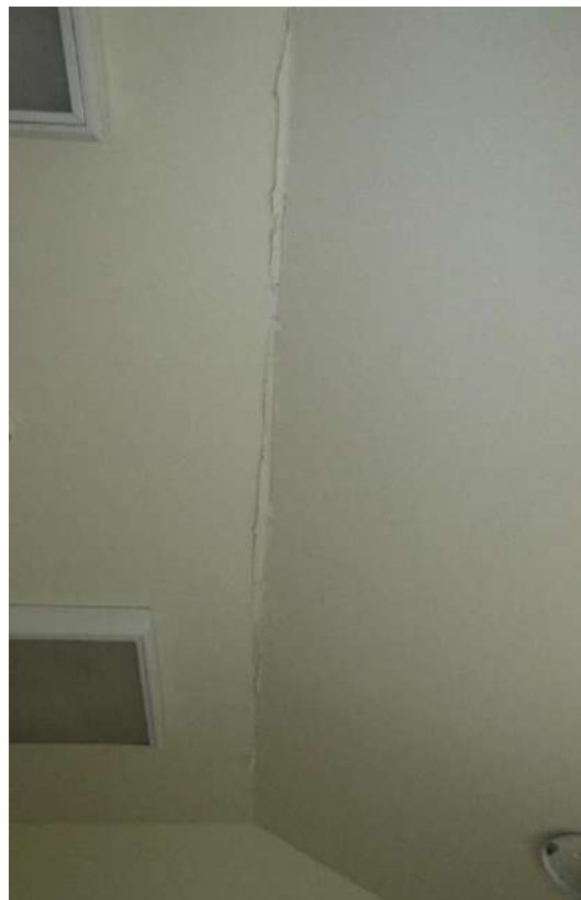
Рисунок 7.12 – Утворення тріщин по гіпсокартонному опорядженню стелі в осях Б-Г, 3-5 (приміщення №23)
