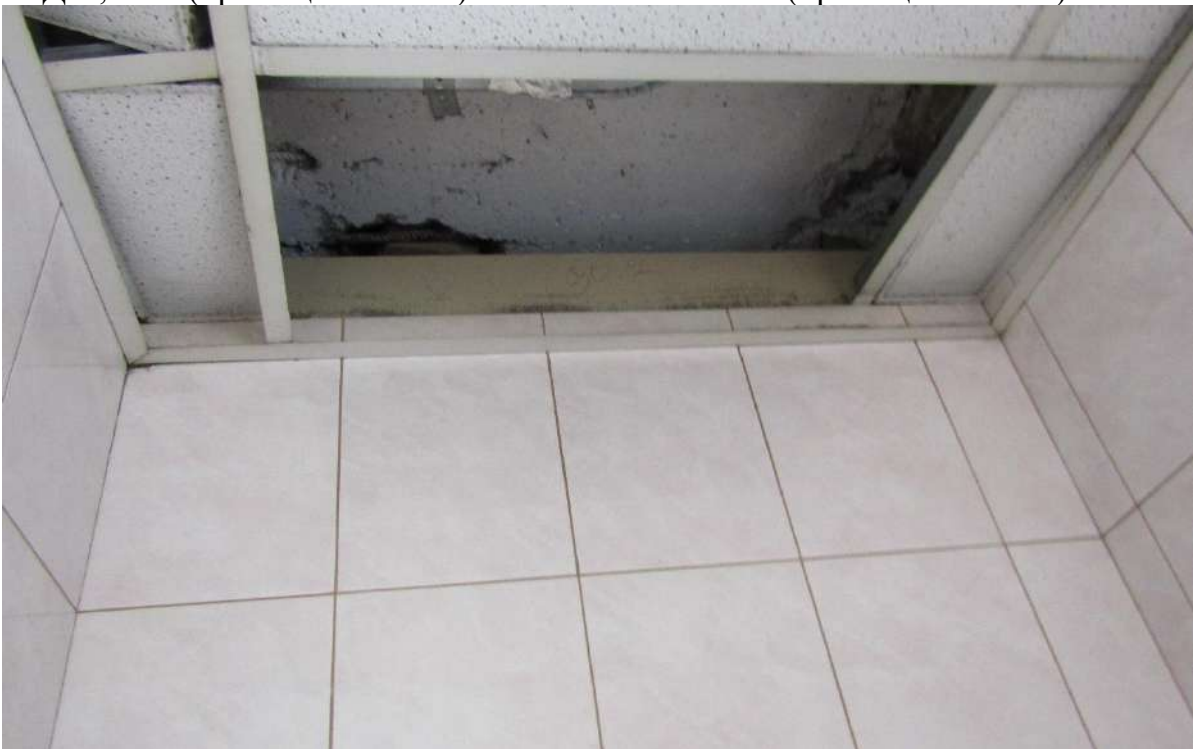
Рисунок 6.3 – Деформована підвісна система типу армстронг в осях Д-Е, 9-10 (приміщення №26)
