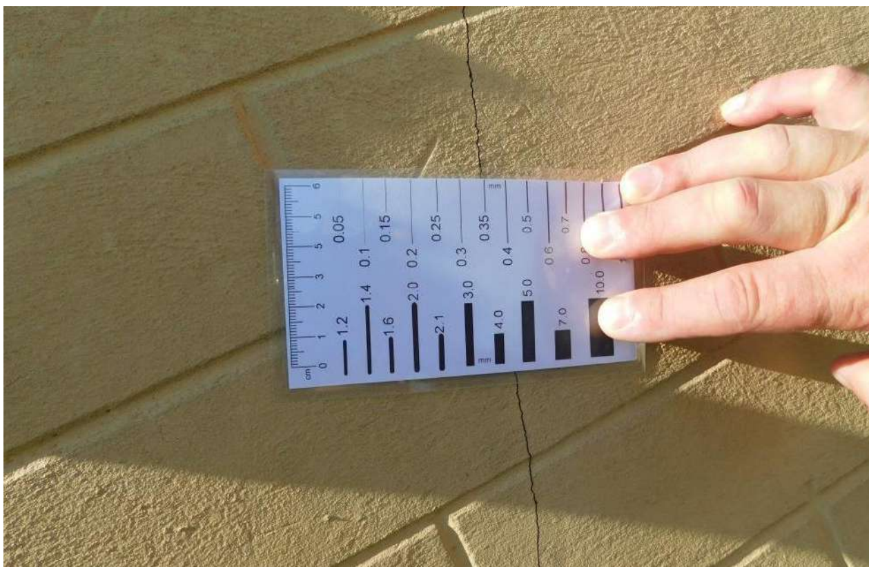
Рисунок 8.29 – Утворення тріщин по опорядженню бокового фасаду на рівні мансардного поверху в осях 13, А-Е
