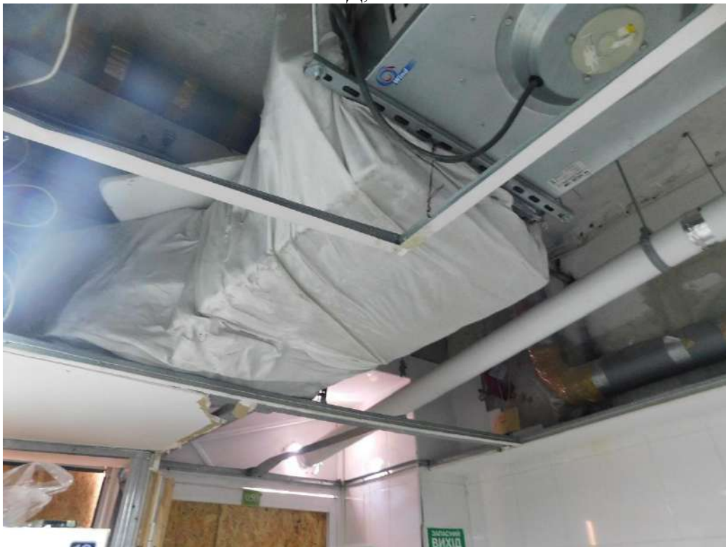
Рисунок 2.3 - Руйнування підвісної стелі системи «Армстронг» приміщення 1 в осях Г-Д,1-2
