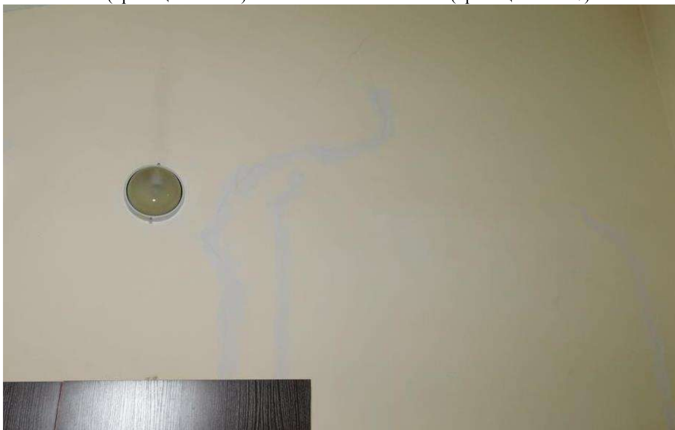
Рисунок 3.25 – Вертикальні тріщини по опорядженню стіни над дверним отвором в осях 2, Д-Е (приміщення №17)
