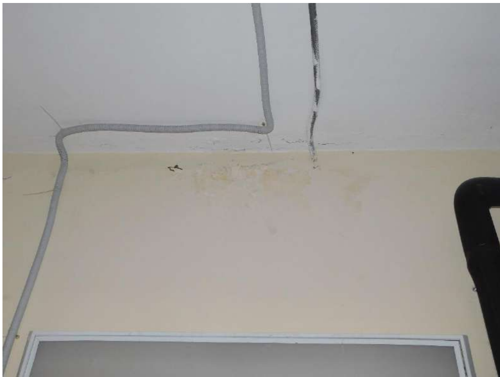
Рисунок 2.7 - Сліди замокання, пошкодження поверхневого шару фарбованої поверхні стіни приміщення 77 в осях А-Б,15-16
