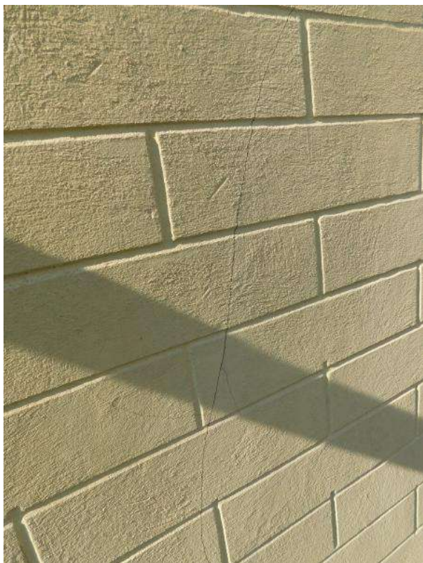
Рисунок 8.26 – Утворення тріщин по опорядженню бокового фасаду на рівні мансардного поверху в осях 13, А-Е
