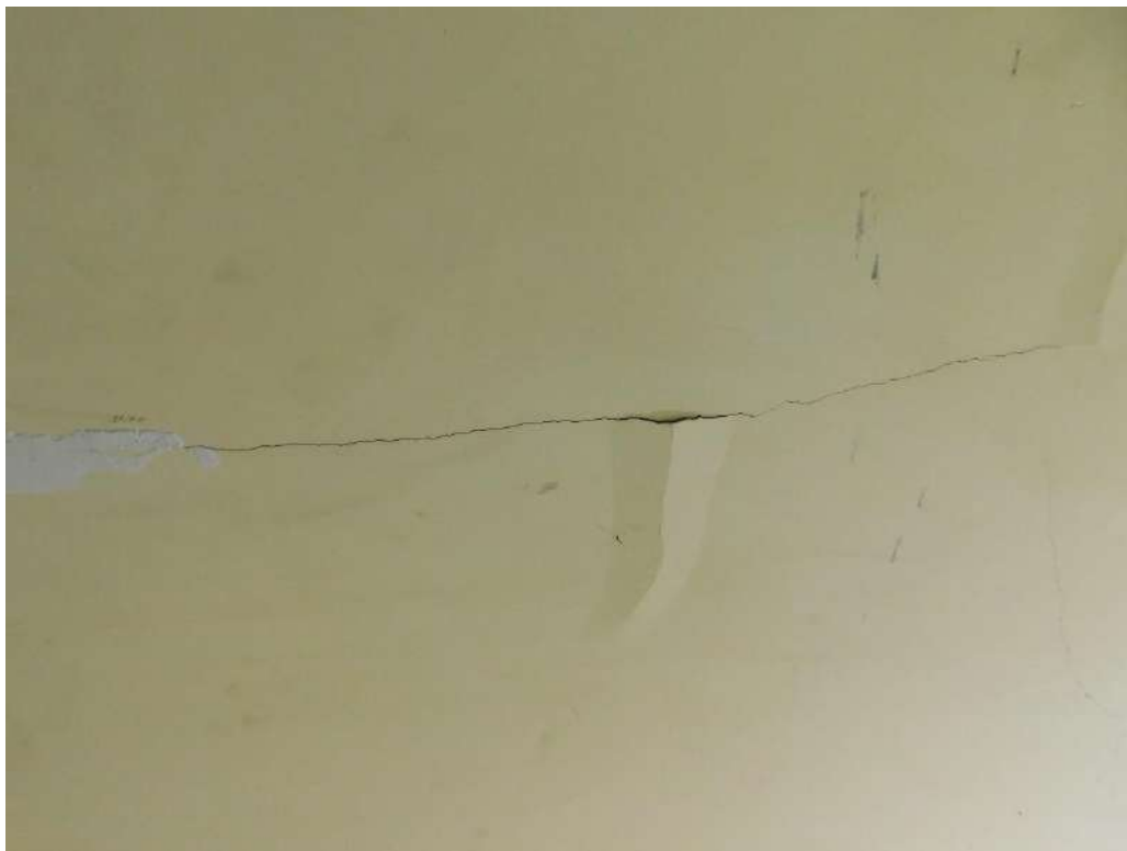
Рисунок 2.11 - Тріщини та відшарування штукатурного опорядження стіни приміщення 81 в осях В/Г-Г,13-14
