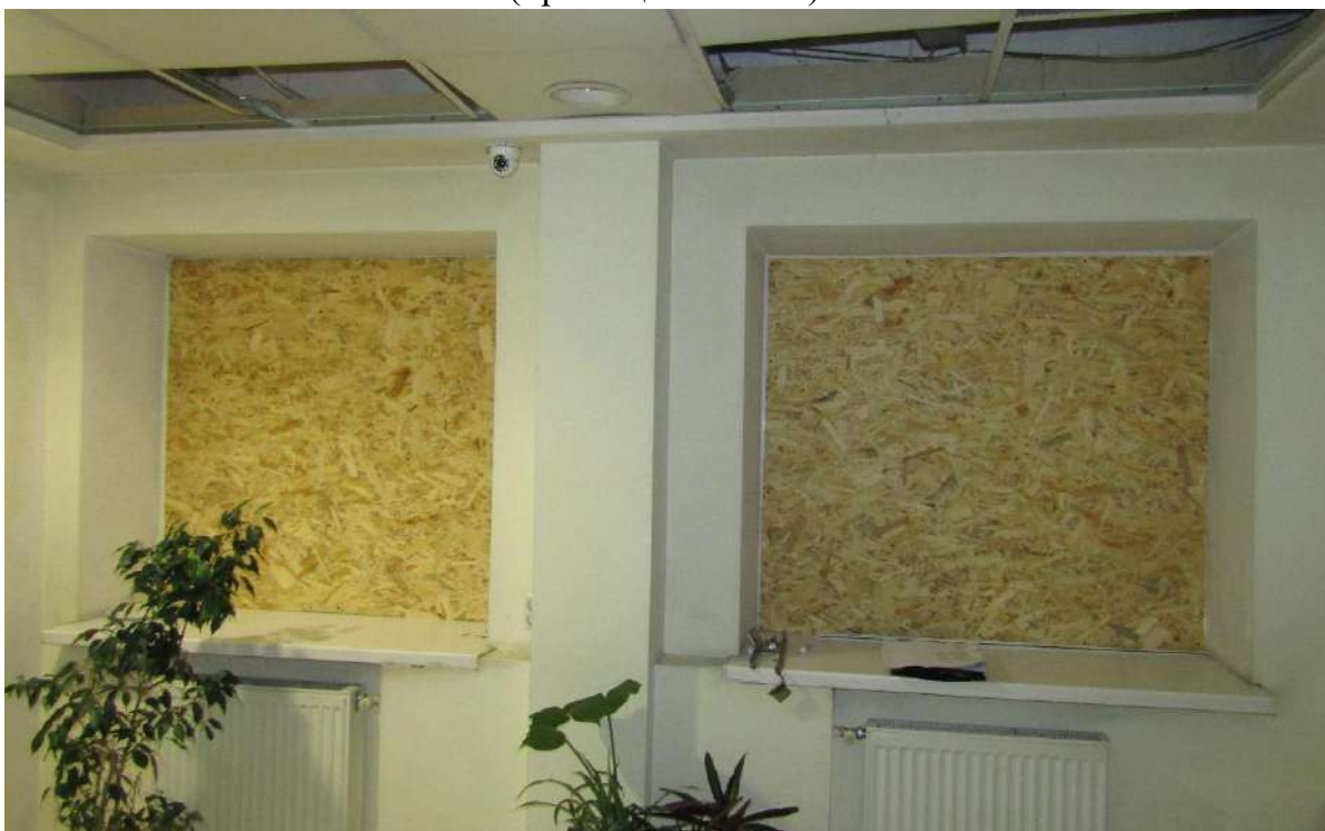
Рисунок 6.7 – Зруйновані/відсутні віконні заповнення в осях Г-Д, 1 (приміщення №2)
