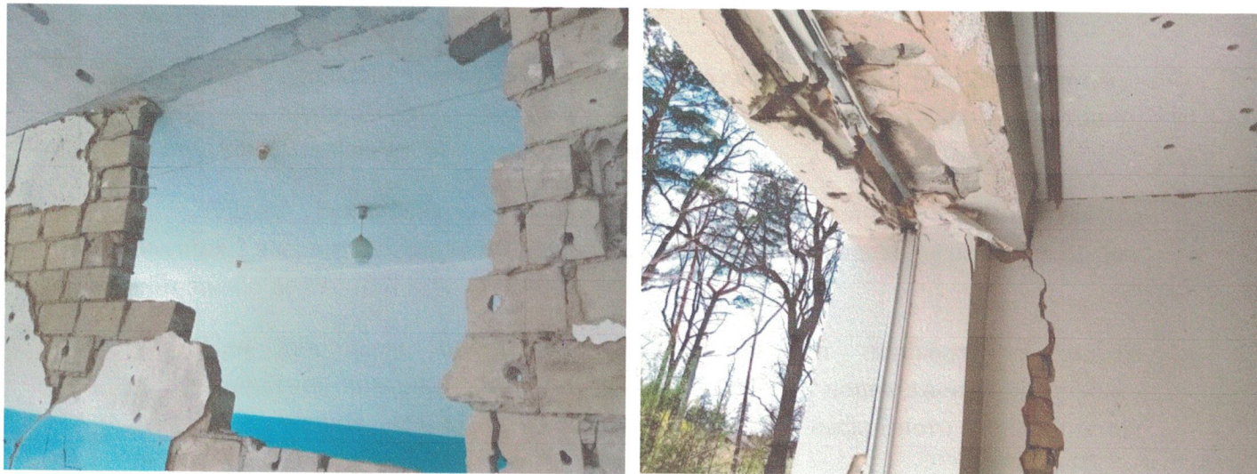
Фото зруйнованої перегородки і вертикальної тріщини
