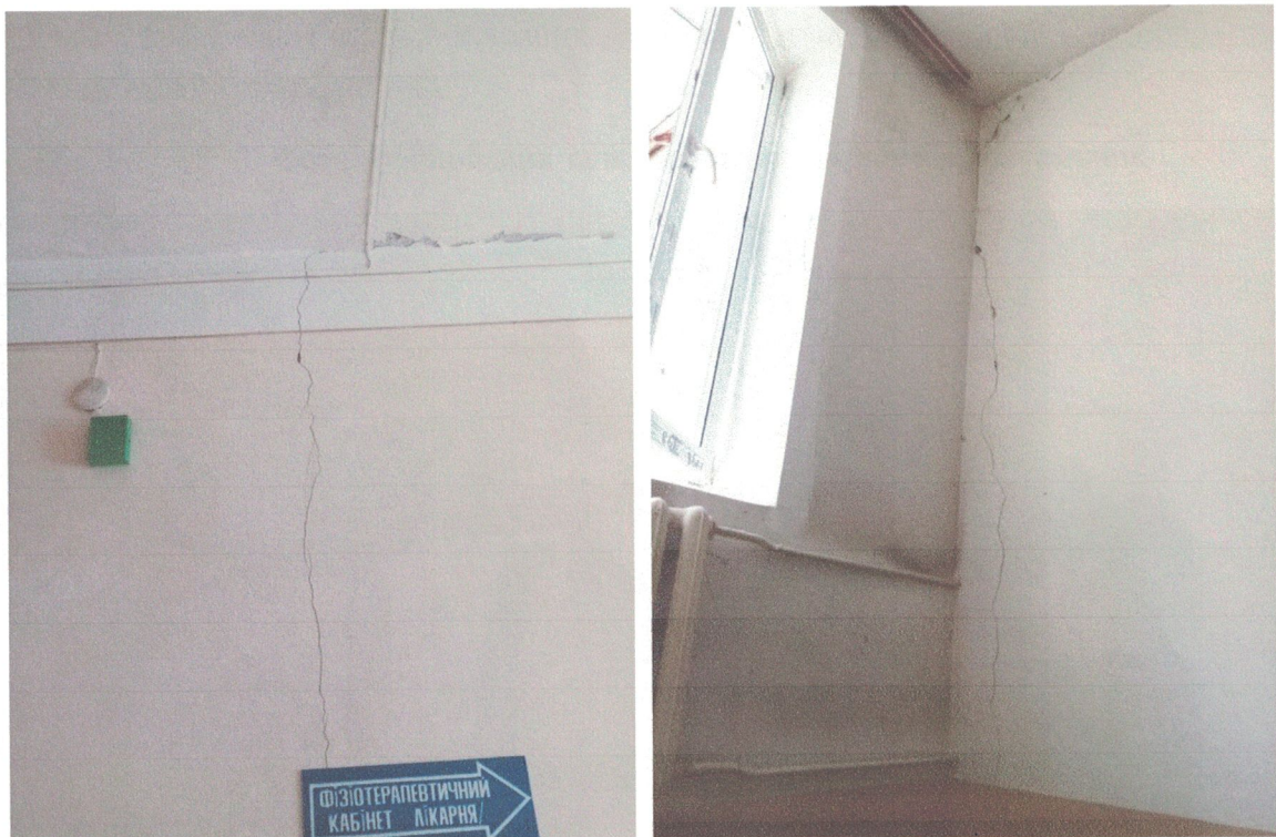
Фото тріщин на внутрішніх стінах
