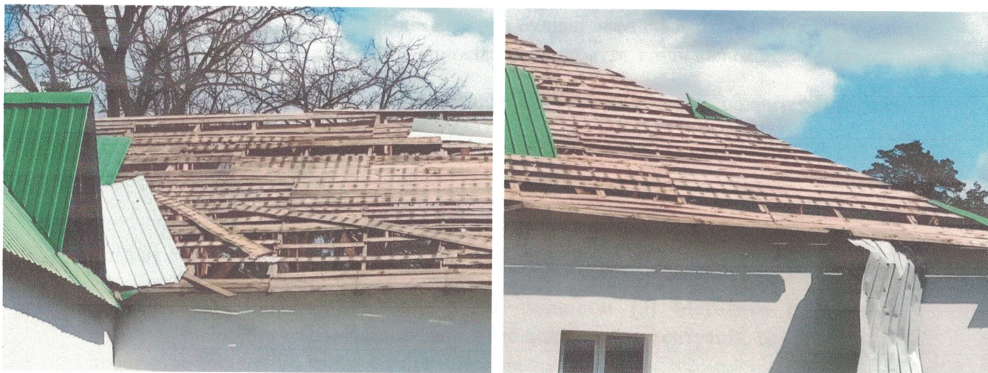
Фото пошкоджень кроквяного даху
